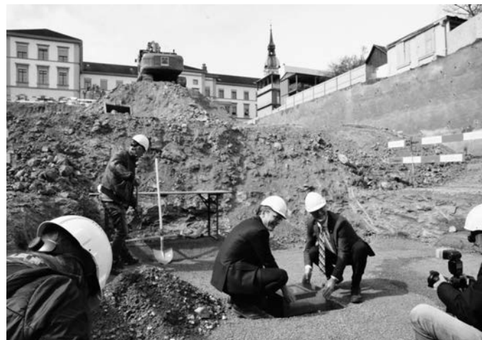
Dominik Diezi (Mitte links), Chef des Departements für Bau und Umwelt, und Walter Schönholzer, Chef des Departements für Inneres und Volkswirtschaft, versenken die Zeitkapsel im Boden unter dem künftigen Ergänzungsbau.
